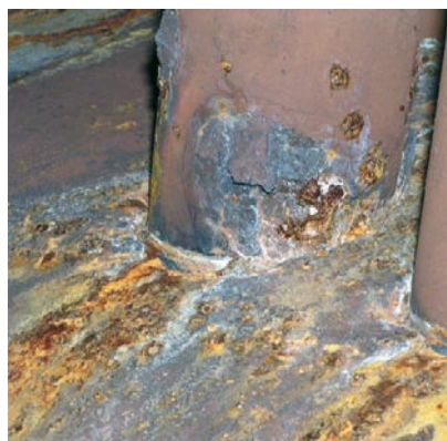
受到腐蚀的锅炉炉膛穹顶和对流管
